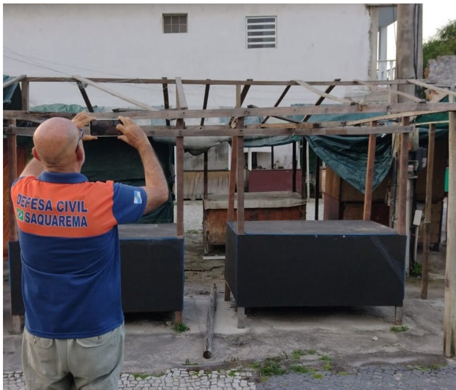
Agentes da Defesa Civil fizeram vistoria na área do Camelódromo do Centro
