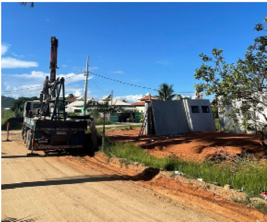
Nova creche já começou a ser construída na Rua 13, esquina com a Rua 72
