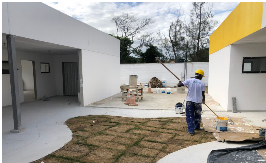
Nova creche está sendo construída às margens da Rua Teresópolis, em Ipitangas
